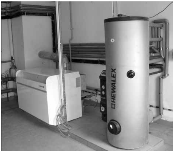
Nowa kotłownia w Szkole Podstawowej w Błażowej Dolnej.
