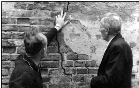
Pęknięcie ściany kościoła.
