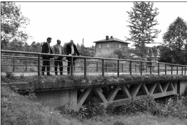
Planowana przebudowa mostu na rzece Ryjak na drodze powiatowej nr 1422 w Nowym Borku.
