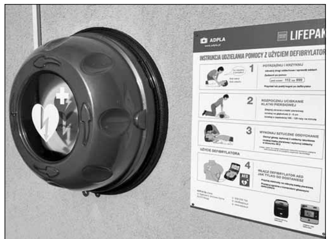
Na ścianie frontowej błażowskiej Przychodni Rejonowej został zamontowany defibrylator.
