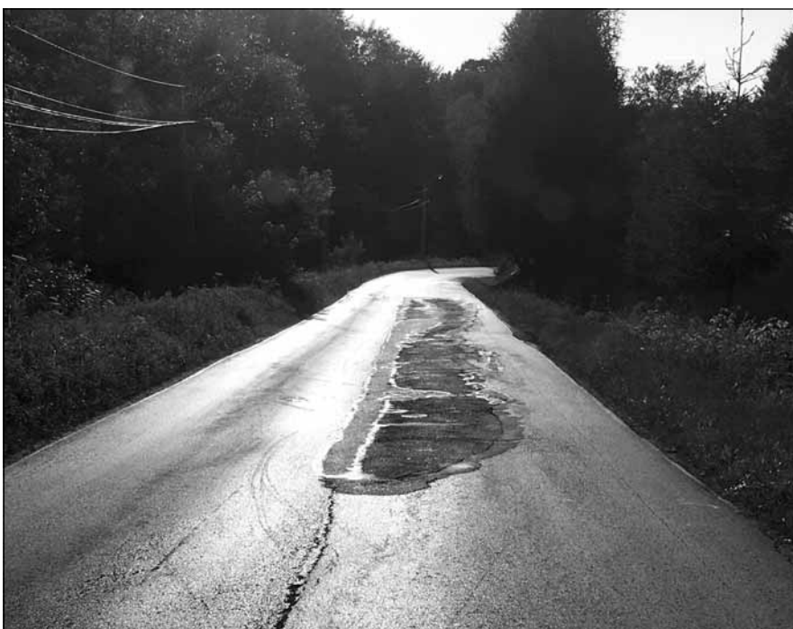
Remont osuwiska w Piątkowej.
