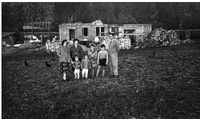
Rodzina Koszykowskich oraz Zofia Wlazło z córką przed budową nowej lecznicy dla zwierząt w Błażowej.
