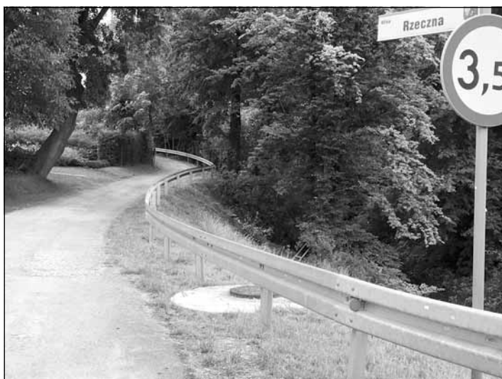
Zakończony został montaż ochronnych barier drogowych. Na drogach gminnych w miejscowościach Błażowa, Błażowa Górna i Lecka zamontowanych zostało ponad 300 metrów takich zabezpieczeń. Działania takie mają zwiększyć bezpieczeństwo użytkowników tych dróg.
