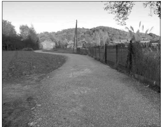
Po wielu latach braku możliwości przejazdu ulicą Ogrodową w Błażowej udało się udrożnić ten 200 metrowy odcinek drogi gminnej. Wykonano podbudowę z łupka oraz nawierzchnię tłuczniową.
