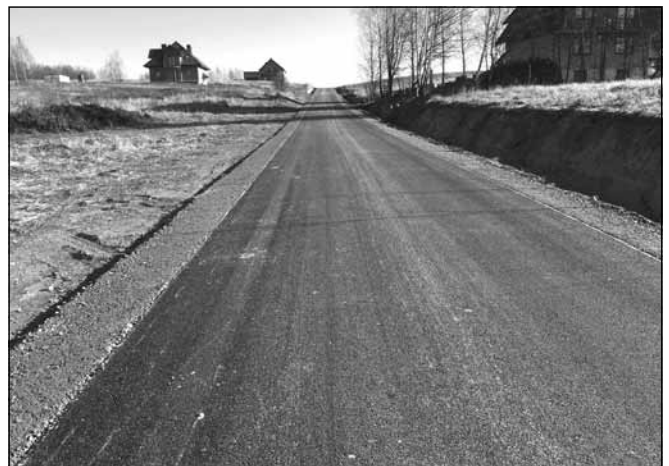
Zakończyła się przebudowa drogi gminnej administracyjnie leżącej w Piątkowej stanowiącej łącznik pomiędzy ulicą Jagiellońską i Działową w Błażowej, a drogą powiatową tzw. „Łańcucką”.
