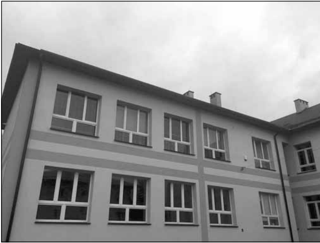
Dobiegła końca termomodernizacja Szkoły Podstawowej w Nowym Borku. Inwestycja zakładała docieplenie i odwodnienie fundamentów, ułożenie opaski odbojowej oraz docieplenie ścian i stropu.
