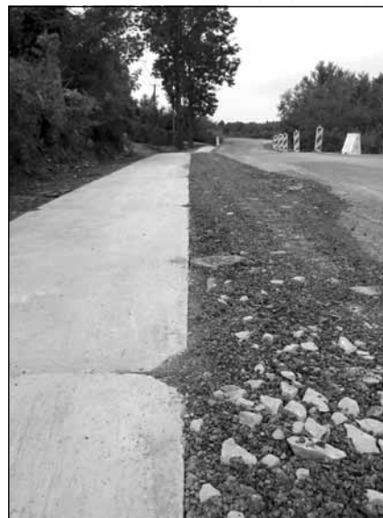
Osuwiska w miejscowości Kąkolówka tymczasowo zabezpieczone.
