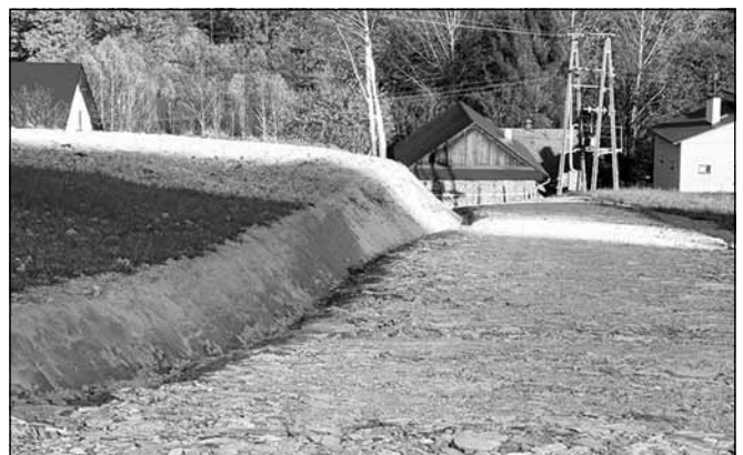
Zakończyła się przebudowa drogi gminnej w Kąkolówce. Na ponad 600-metrowym odcinku została położona nowa łupkowo-tłuczniowa nawierzchnia.
