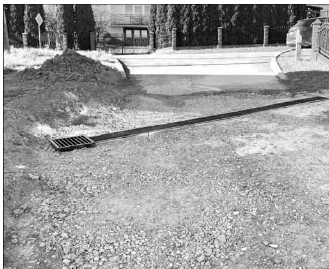
Dobiegła końca rozbudowa kanalizacji deszczowej na ulicy Pułaskiego, Kościuszki, Żeromskiego i Witosa w Błażowej.
