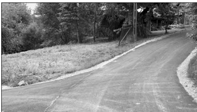
W ramach funduszu soleckiego w Futomie zostały przebudowane dwie drogi gminne nr 2835 i 2802.
