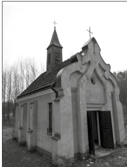
Kaplica przed remontem.
